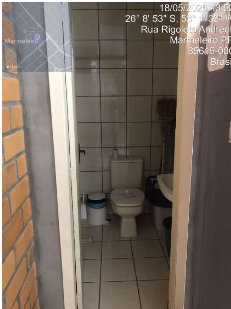
Figura 07: Vista interna bwc (18/05/2026).
